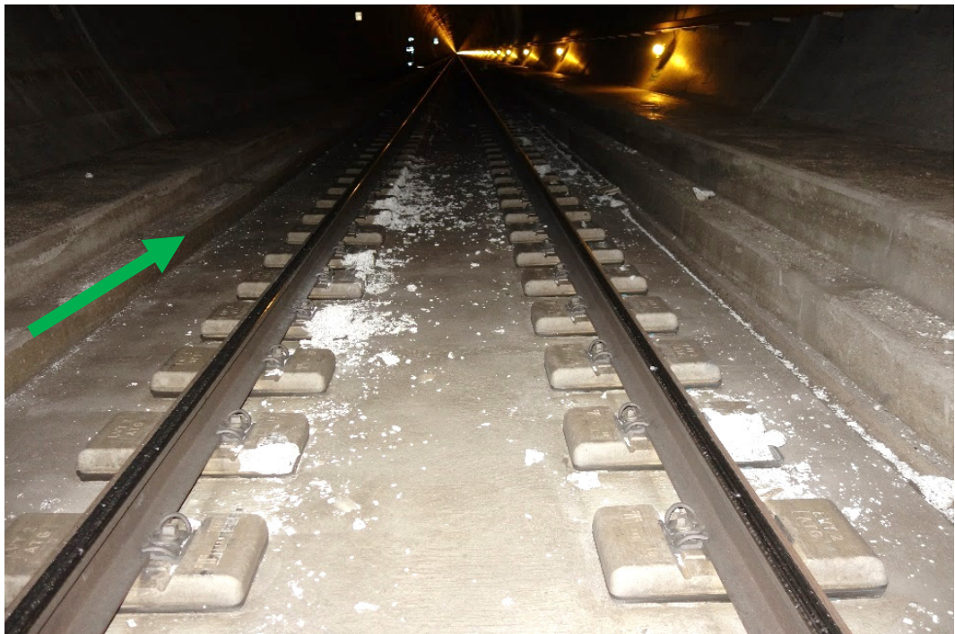
Abbildung 41: Durch die entgleiste Achse beschädigte Betonschwellen links und rechts des Gleises (km 46.7).
