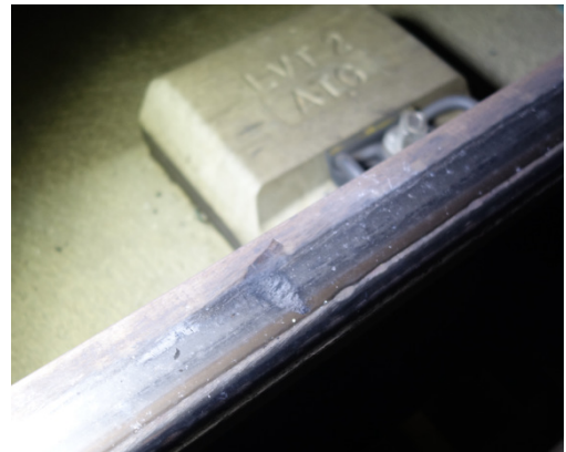
Abbildung 40: Weitere Spur auf dem in Fahrtrichtung rechten Schienenkopf (km 46.9–46.8).
