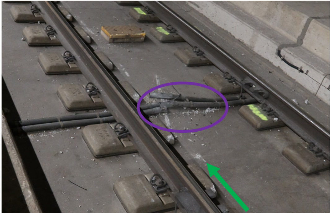
Abbildung 50: Beschädigte Verkabelung des Achszählers von Abschnitt 7707.
