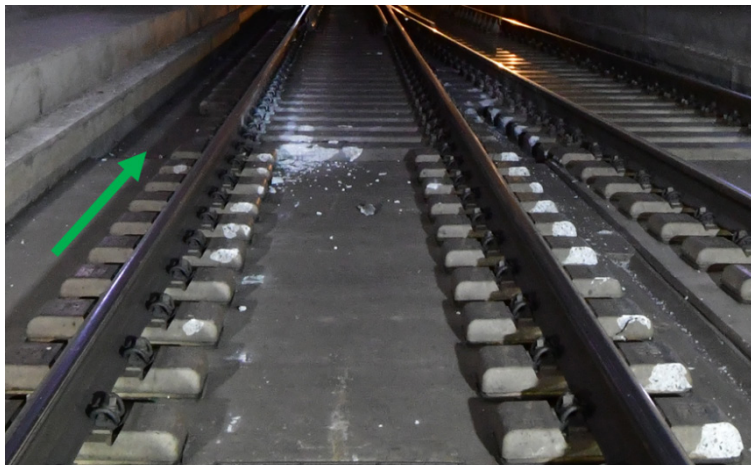
Abbildung 45: Massive Anschlagspuren an der ersten Monoblockbetonschwelle der Weiche W387.
