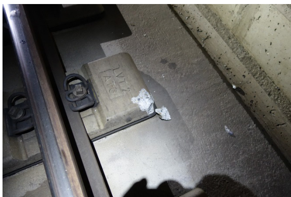
Abbildung 37: Beschädigung der Betonschwelle bei km 47.1 durch abgebrochenes Radstück der Achse 1 des Wagens 11.
