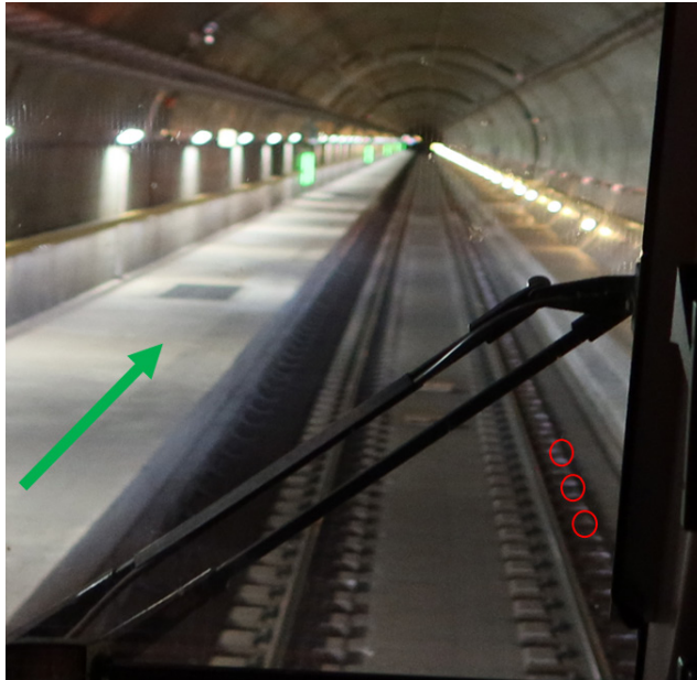
Abbildung 44: Die Aufnahme aus dem Führerstand des Lösch- und Rettungszuges (LRZ) bei km 41.1 zeigt die leichten Beschädigungen zwischen km 46 und 41, hier auf der rechten Seite der Betonschwellen (rote Kreise).
