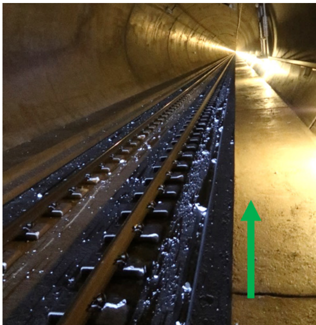
Abbildung 43: Schleifspuren des auf dem Tunnelboden aufliegenden Spurkranzes sowie Trümmerteile von beschädigten Betonschwellen (ca. km 46.5).
