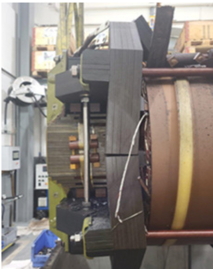
Abbildung 9: Beschädigter Trafo mit Verformung des magnetischen Kreises (Quelle: SBB).
