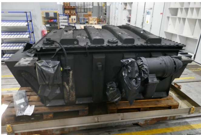
Abbildung 3: Sichtbare Deformierung des Transformatordeckels der Re 450 025.
