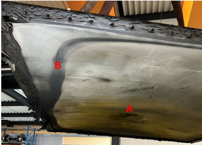
Abbildung 4: Ausgebauter Transformatordeckel, Ansicht Innenseite. A: Verformung durch die Explosion. B: Russablagerung.
