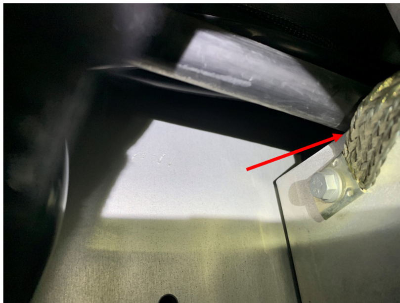
Illustration 7 : Trolleybus N° 6. Un câble 24 V (95 mm 2 ) frottait sur le champ d'une pièce équerre métallique (flèche rouge). Aucune protection contre les arêtes vives n'était installée.
