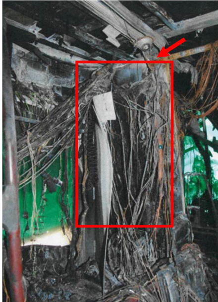
Illustration 10 : Rectangle rouge : tableau électrique situé derrière le siège conducteur. Flèche rouge : arrivée du câble 24 V alimentant le tableau électrique.
