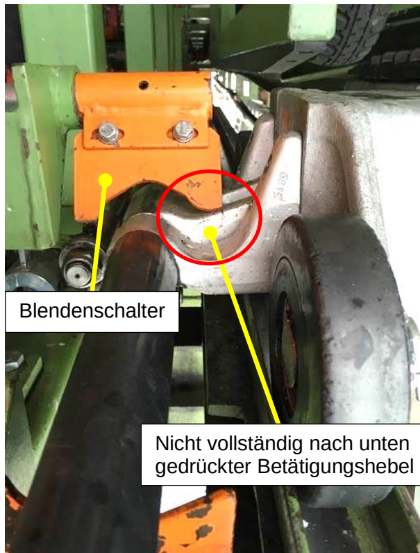
Abbildung 2: Blendenschalter „Klemme Seil oben“: Die nicht korrekt gekuppelte Klemme passt nicht an der Kontur vorbei (Kreis) und löst den Blendenschalter aus.
