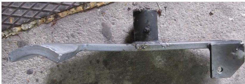
Foto 12: verkrümmter bergseitiger Seilabweiser Stütze 33
