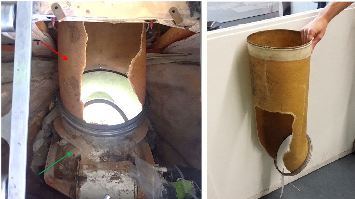
Abbildung 1: Beschädigter air duct (roter Pfeil) am equipment overboard exhaust valve (grüner Pfeil). Das rechte Bild zeigt den ausgebauten, beschädigten air duct .
