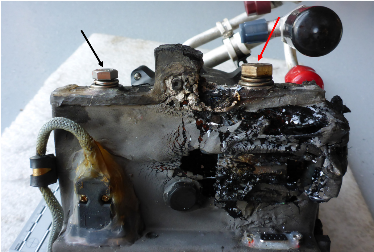
Abbildung 5: Seitenansicht des controller des Kompressors mit Pluspol (roter Pfeil) und Minuspol (schwarzer Pfeil).
