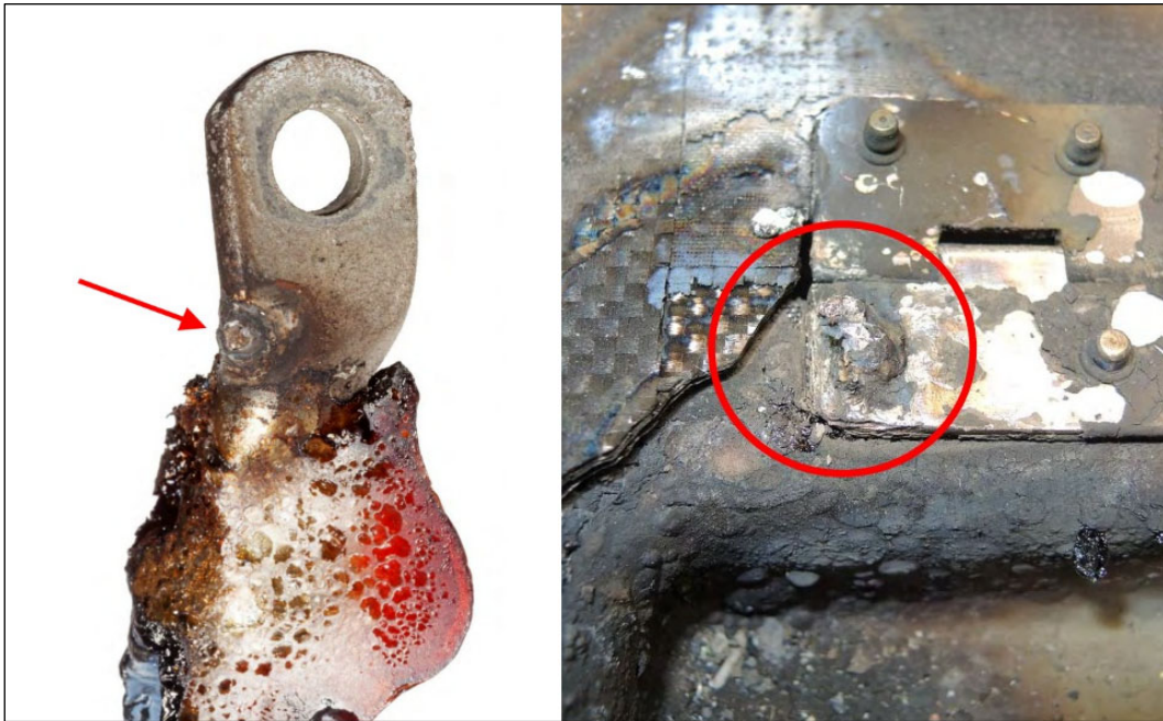
Abbildung 3: Der Kabelschuh und der Nietkopf, zwischen denen der Kurzschluss erfolgte. Der Pfeil und der Kreis bezeichnen die Kontaktstelle, wo die Bauteile angeschmolzen waren.
