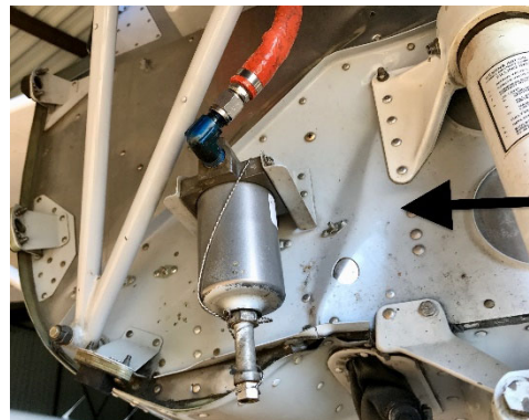
Figure 2 : déformations de la cloison pare-feu
