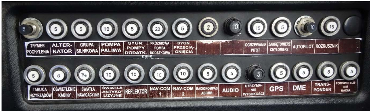
Figure 3: tableau des disjoncteurs ( circuit-breakers ) du HB-PJP, les identifications de ceux-ci ne sont pas conformes au POH de l'avion HB-PJP.
