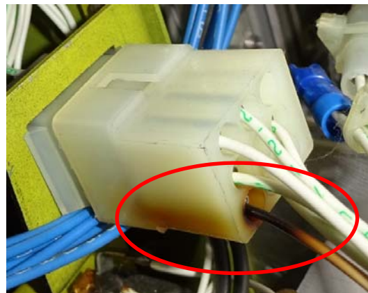
Figure 2: connecteur multiple et câblage défectueux.
