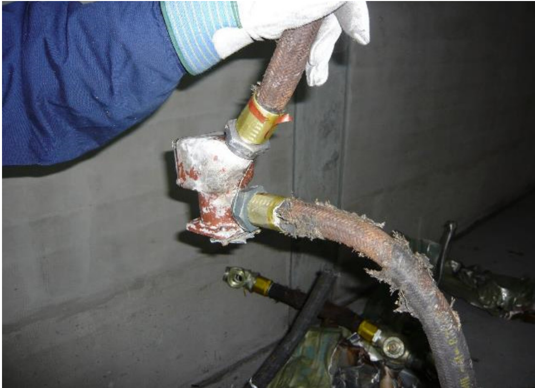
Abbildung 13: Ausgeprägte Alterungsschädigungen an einem Schlauch
