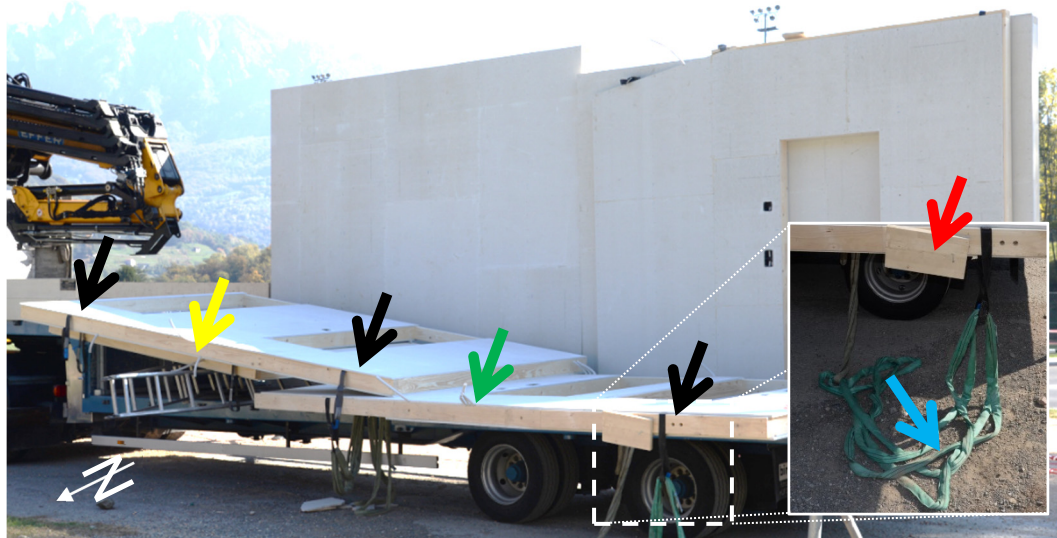
Figura 1: Prefabbricati in legno e cartongesso dopo il ribaltamento senza la piastra di sicurezza completamente staccata (freccia rossa), le due cinghie ad anello continuo verdi (freccia blu), la posizione nella quale si trovava il mastro carpentiere (freccia verde) e dove è stato colpito l'autista dell'autoarticolato (freccia gialla). Ad ambedue le parti degli elementi prefabbricati sono state allacciate delle cinghie ad anello continuo nere (freccia nera).
