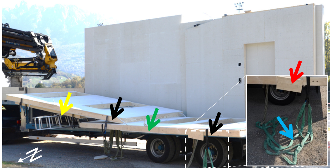
Abbildung 1: Fertigbauelemente aus Holz und Gipskarton nach dem Umkippen mit nicht vollständig gelöster Sicherungsplatte (roter Pfeil), den beiden grünen Rundschlingen (blauer Pfeil), und den Stellen, an denen der Lehrmeister (grüner Pfeil) sowie der Fahrer des Sattelschleppers (gelber Pfeil) getroffen wurden. An beiden Seiten der Fertigbauelemente wurden schwarze Rundschlingen verbaut (schwarzer Pfeil).
