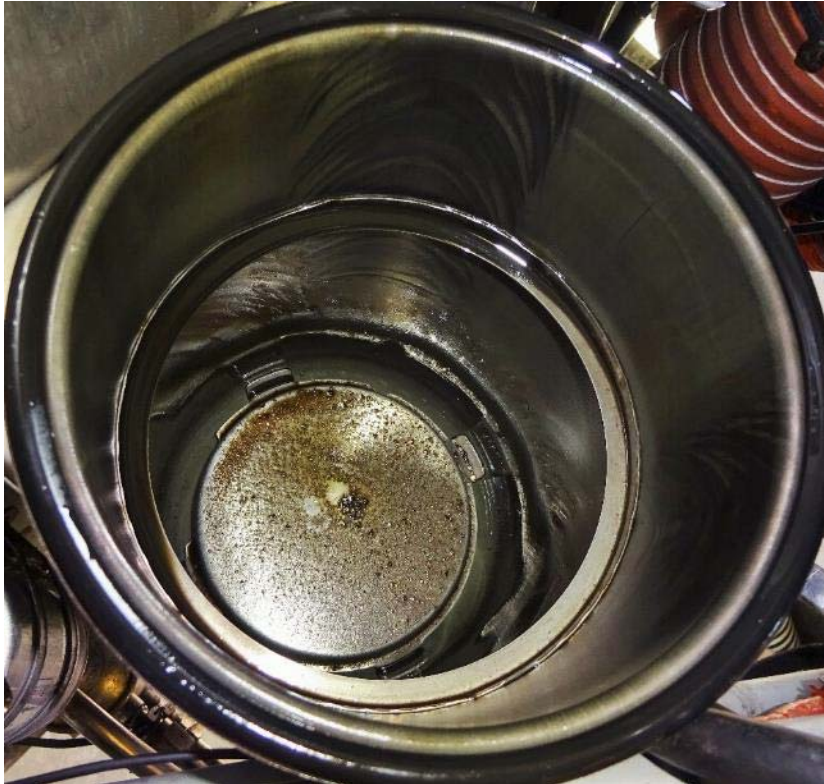
Abbildung 5: Sicht von oben in den Ölbehälter. Die eingelegte Zwischenwand ist am unteren Ende sichtbar, der Schwalleinsatz fehlt.
