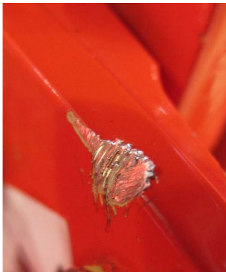
Abbildung 4: Detail der beschädigten Kante des Flachprofils mit plastischem Abdruck der Oberflächenstruktur des Seils.
