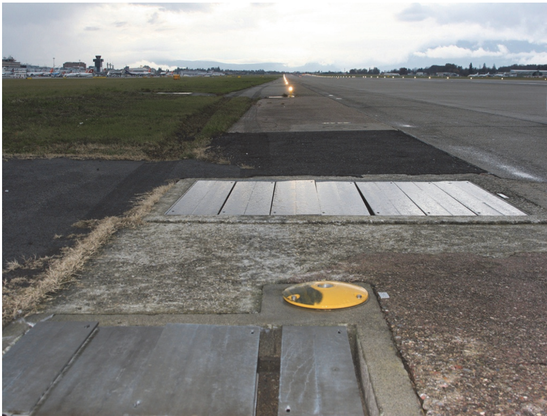
Figure 6 : base du feu de bord de piste n° 2044 portant les traces de la roue intérieure du train principal gauche
