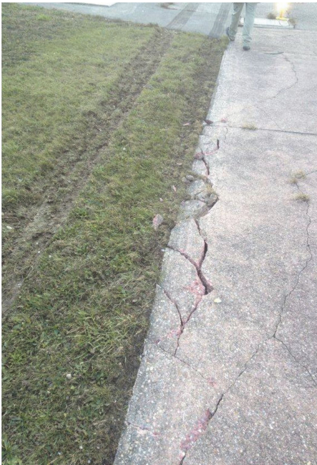
Figure 7 : fissures dans le béton provoquées par le passage de la roue intérieure du train principal gauche
