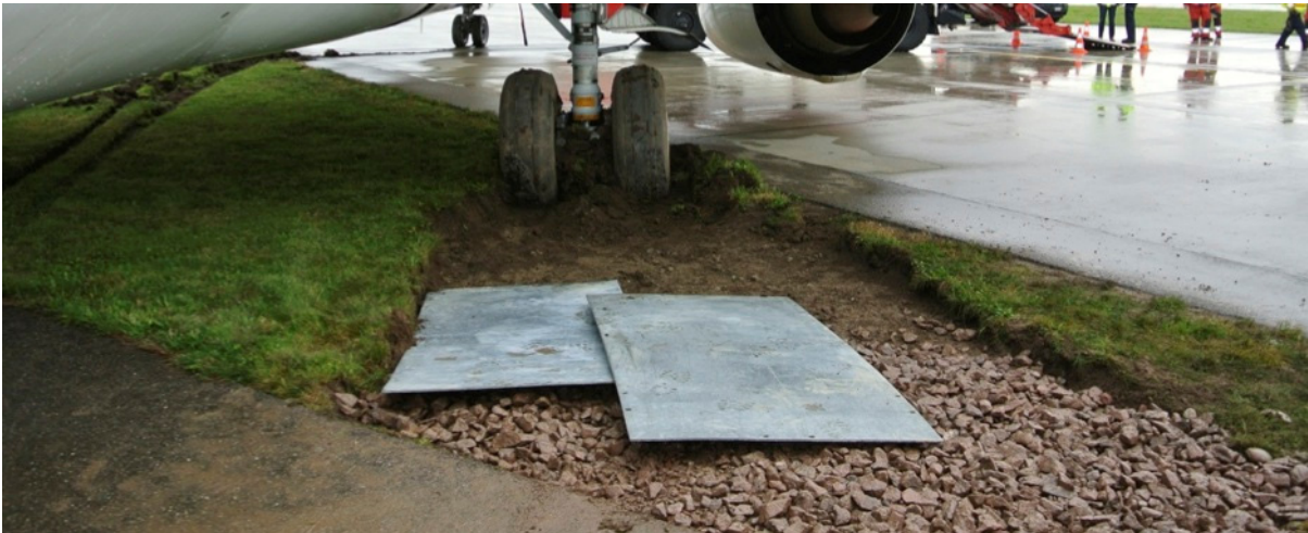
Abbildung 21: Entfernen des Erdreichs hinter dem rechten Hauptfahrwerk, Schaffen einer tragfähigen Unterlage, rechts de-icing lane F2
