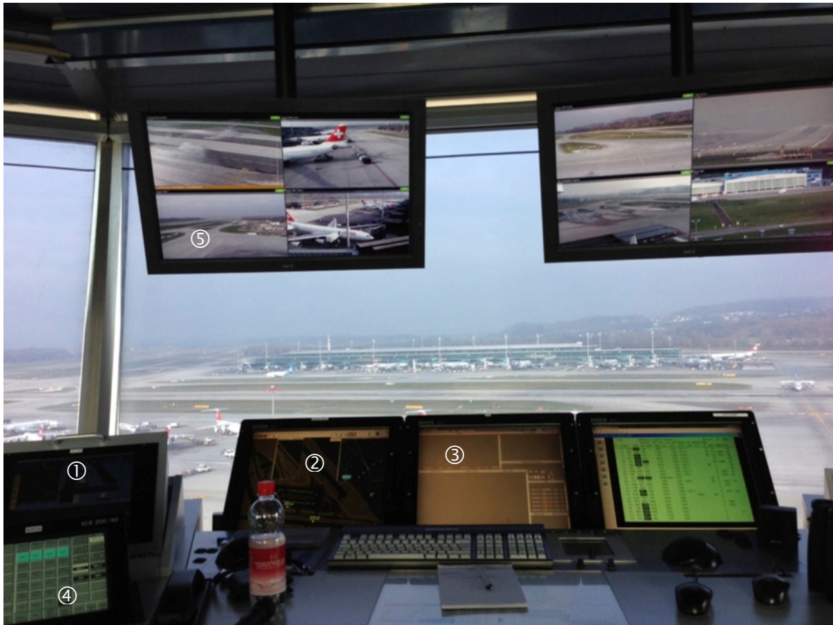
Abbildung 25: Arbeitsplatz apron control north . Der Arbeitsplatz ist ähnlich ausgerüstet wie derjenige der Flugverkehrsleiter bei skyguide.
