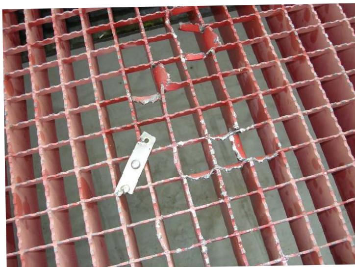
Bild 5: Ausgerissene Befestigung und Beschädigung am Gitterrost
