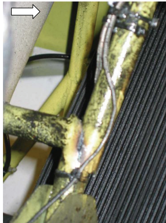
Gebrochenes vorderes Rohr des H-strut
