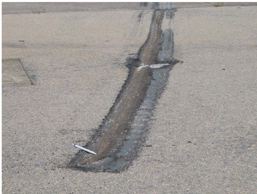
Foto n. 12: solco nella pavimentazione.
